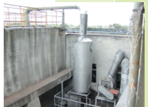
空氣污染防治設備
